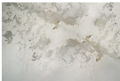
Figura 3.9 | Descascamento da pintura
