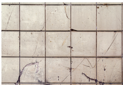
Figura 3.10 | Fissuras em revestimento cerâmico
