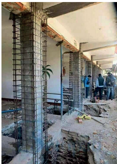
Figura 3.17 | Reforço de pilar por encamisamento
