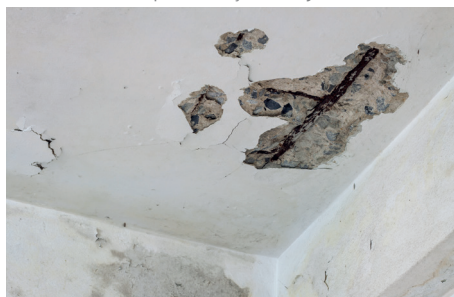
Figura 3.5 | Deslocamento e ataque do aço de laje em concreto
