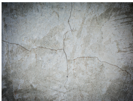
Figura 3.1 | Fissuras em argamassa
