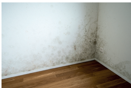
Figura 3.8 | Mofo em pintura
