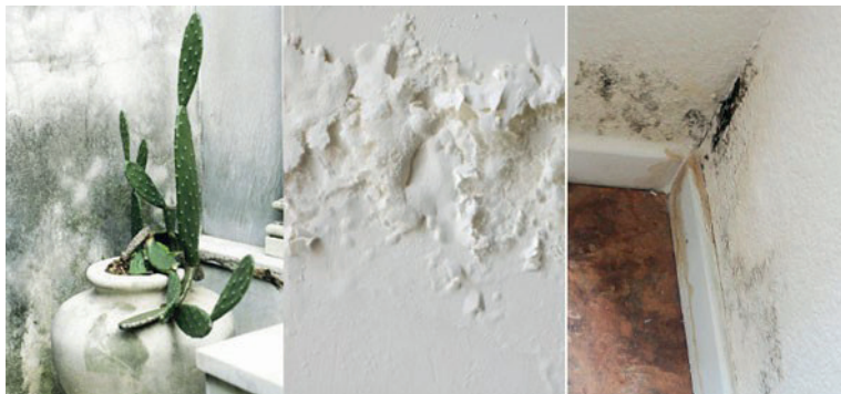
Figura 3.3 | Mancha em superfície devido à passagem de umidade
