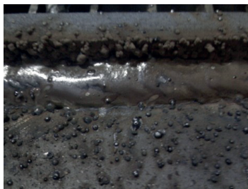
Figura 1.11 (b): Defeitos em soldas, avaliadas por inspeção visual.
