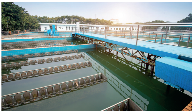
Figura 1.11 | Moderna estação de tratamento de água
