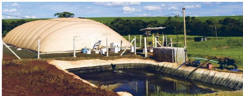
Figura 4.13 | Biodigestor em produção, instalações de controle do gás e depósito de efluentes
