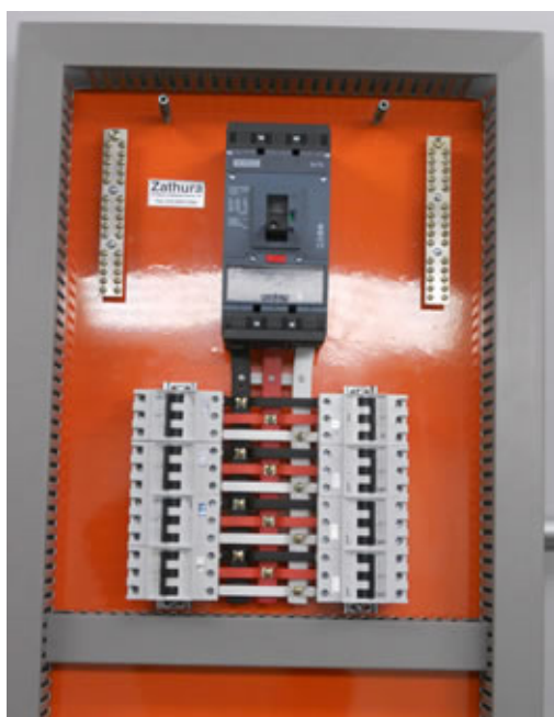
Figura 4.2 | Quadro elétrico com disjuntores e barramentos
