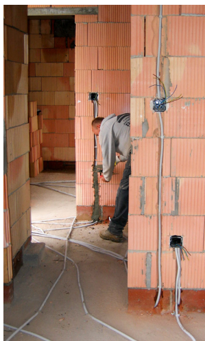
Figura 1.8 | Instalações elétricas embutidas
